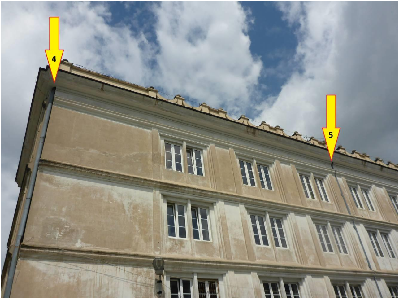
Fot. 2. Fragment ściany nr 2 z dwoma szczelinami zasiedlonymi przez jerzyki
