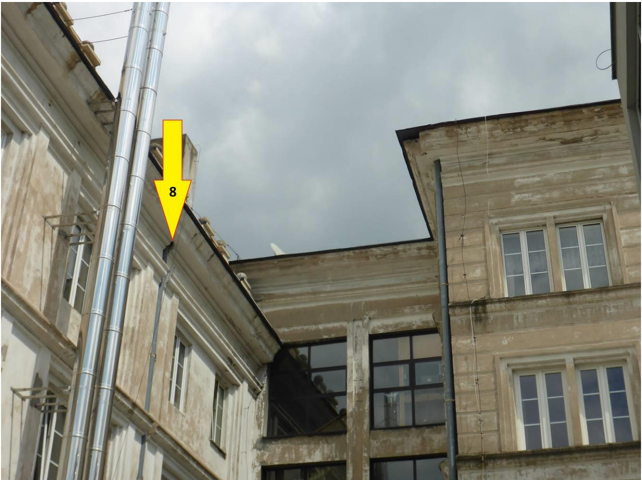
Fot. 4. Wschodni kraniec ściany nr 2 z jedną zasiedloną szczeliną
